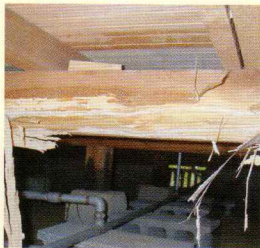
床下の大引がボロボロに。
