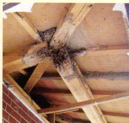
玄関上が被害に…
