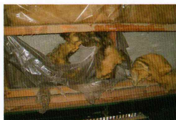
結露により劣化した断熱材
