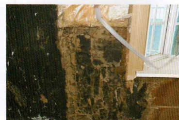
結露によりカビが生えた断熱材
