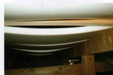
変形したボード系断熱材
