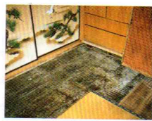
湿気により、腐食菌が発生した床
